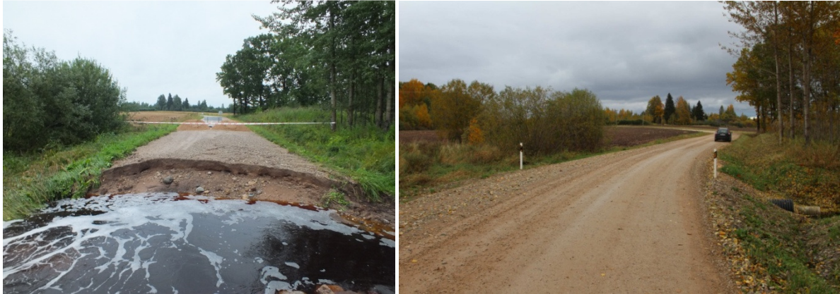
Foto 11. Punkt 2 joonisel 1. 18193 Räpina–Kahkva tee Põlva maakonnas Räpina vallas Suure-Veerksu külas, olukord pärast truubi purunemist 24.08.2017 ja tavaolukorras 10.10.2017.
