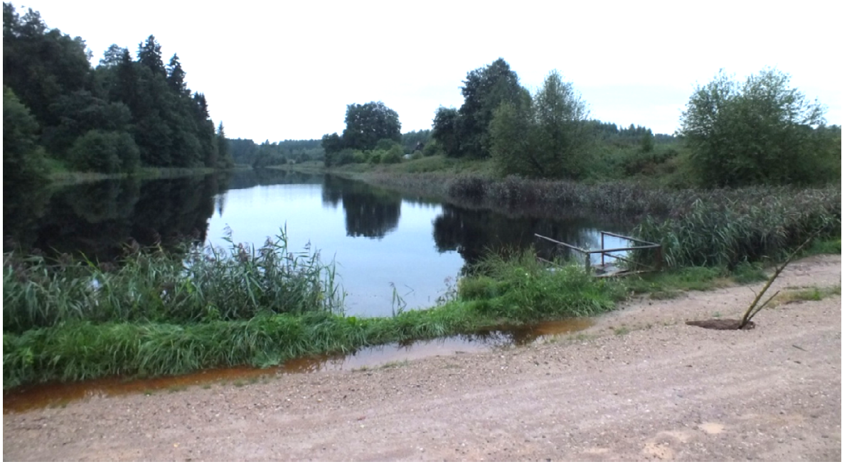
Foto 5. Plotina pais 18207 Niitsiku–Kahkva teel Põlva maakonnas. Varjad liigveelaskme avast on tulvavee läbilaskmiseks eemaldamata, vee tase paisjärves on tõusnud tee pinnaga samale kõrgusele. Tee all olevasse torusse toimub tee muldkeha pinnase sissekanne, selle tulemusena on tekkinud auk, mis on tähistatud puuksaga. Vee ülevooluga kruuskattest kaasneb teekatte erosioon, millele järgneb vee koondumine, mis toob kaasa veelgi suurema erosiooni ja lõpeb muldkeha purunemisega.
